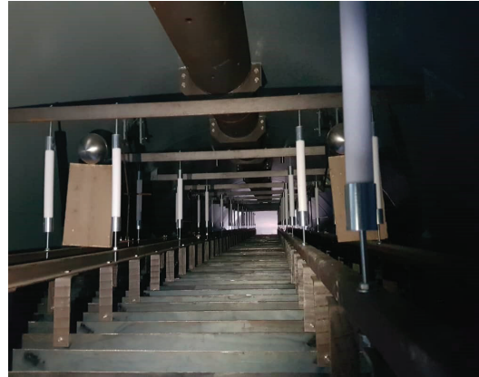
شکل ۶. نمای درونی یک مخزن نمک‌زدا الکترواستاتیکی ترکیبی
