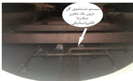
شکل ۸. نمای کلی سیستم شستشوی گل درون مخزن نمک‌زدا
