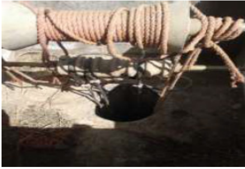
شکل ۱. سر چاه حفاظت کاتدی آبی
